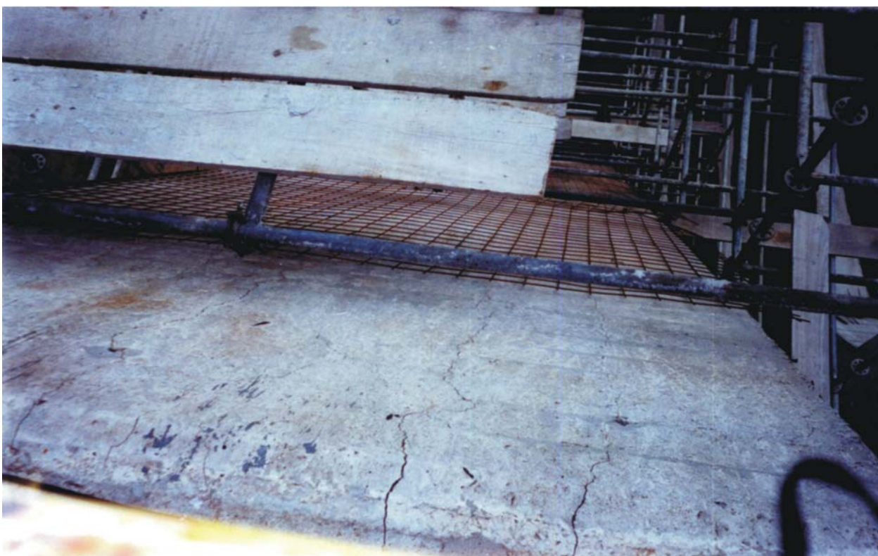
Figura 2.2 Fissuras provocadas por RAA em pilar da Usina de Furnas, passando por recuperação.
