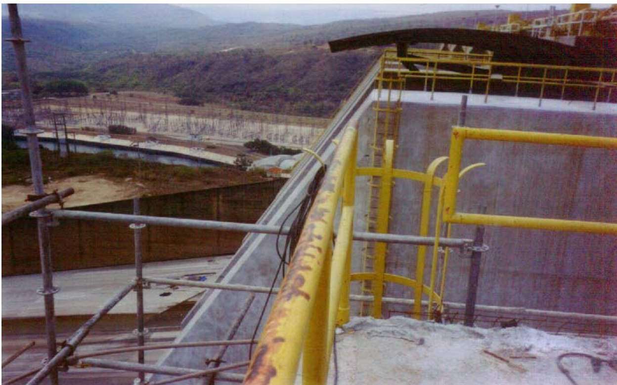
Figura 2.1 Pilar da Usina de Furnas, recuperado após deterioração por RAA.
