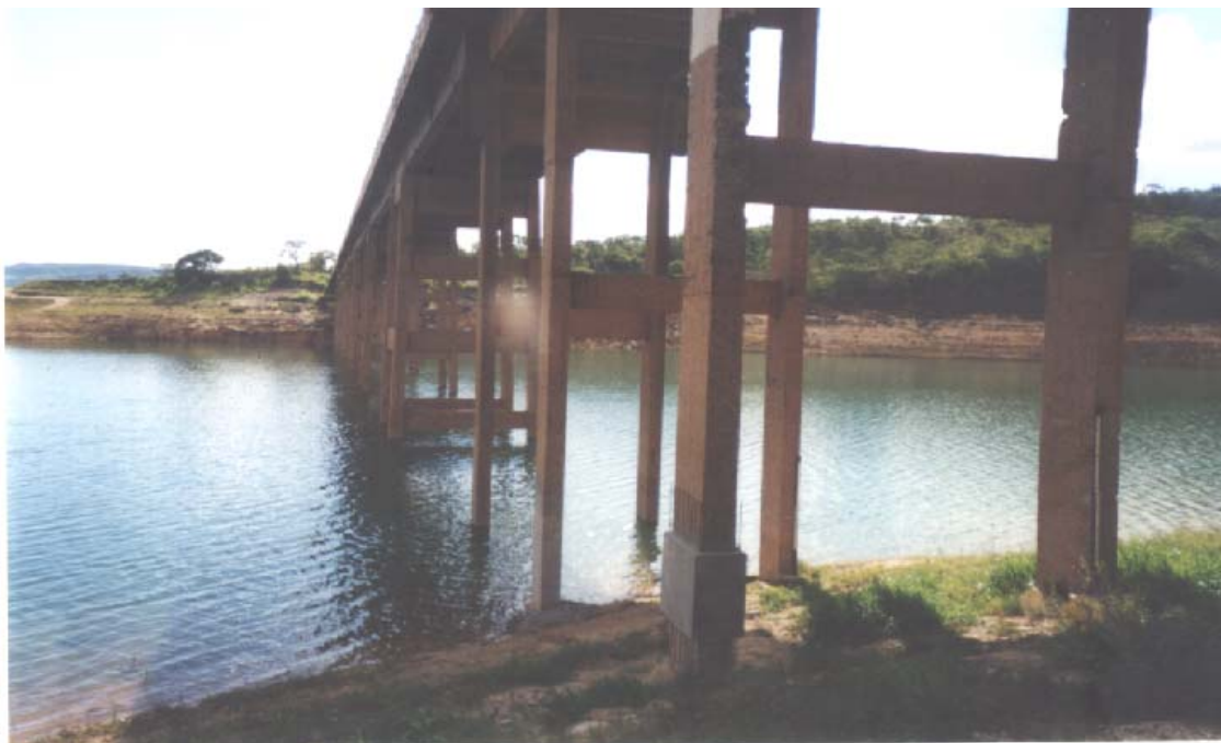
Figura. 2.14 – Armaduras expostas e corroídas no pilar P4; concreto disgregado; Início de reforço do pilar.
