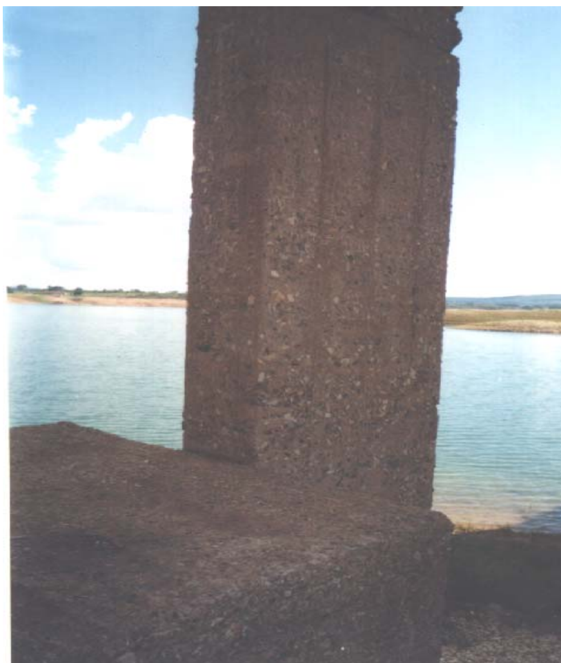
Figura 2.13 –Pilar e bloco com concreto segregado, desagregado e com a superfície irregular.
