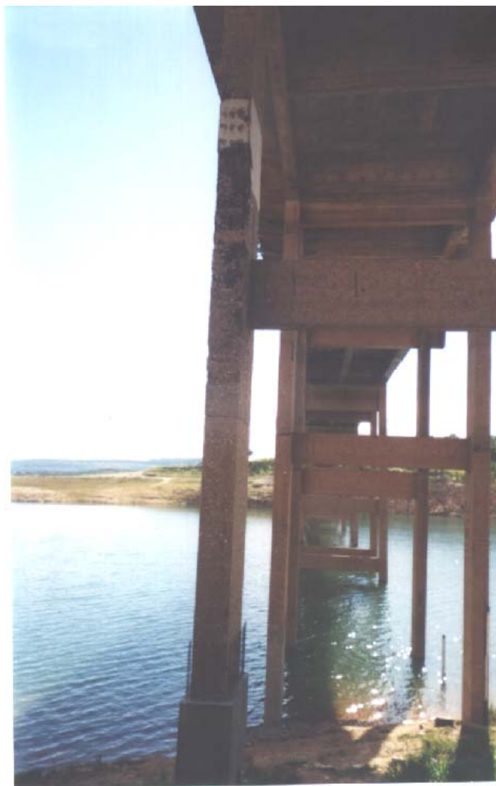
Figura 2.16 –.Armaduras expostas e corroídas pilar P4; concreto disgregado.
