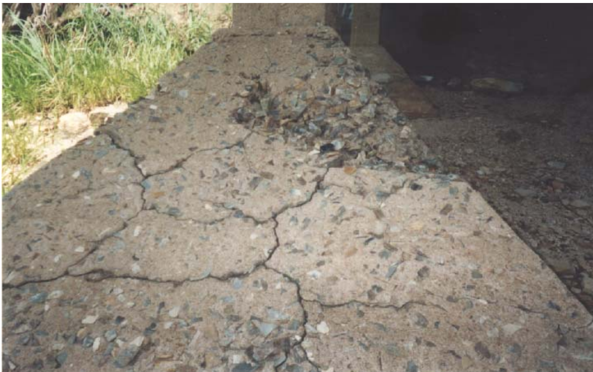
Fig. 2.15 – Fissuras mapeadas na sapata do Pilar P2 – concreto desagregado e segregado.
