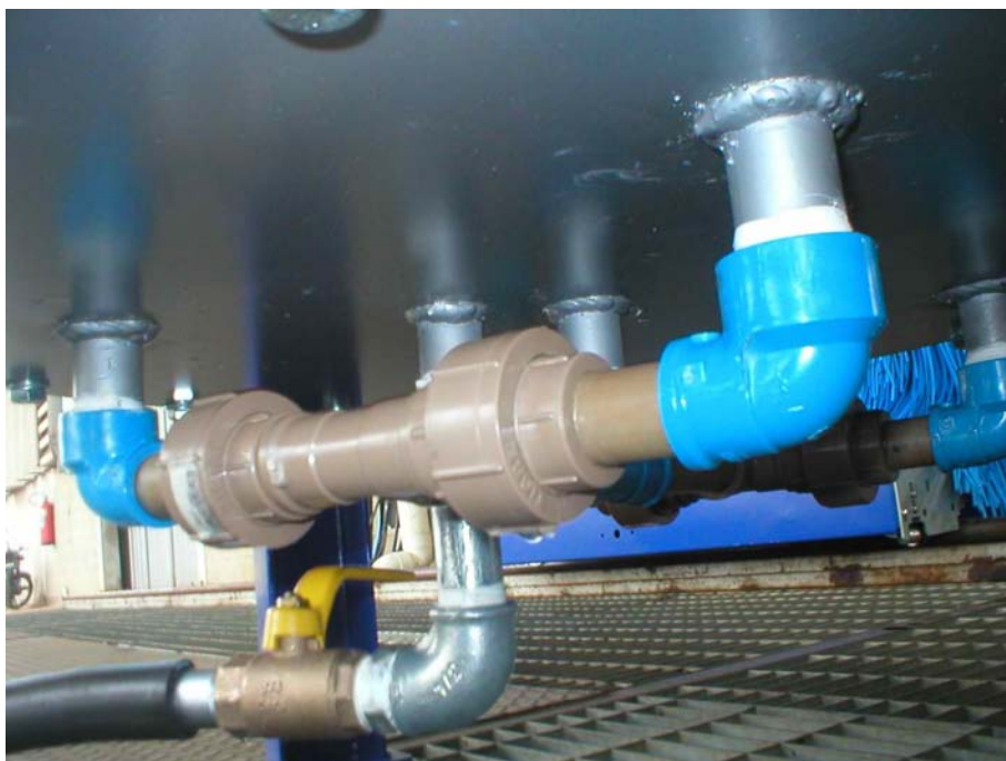
Figura 4.10: Vista externa inferior mostrando o sistema de distribuição de água saturada e descarga de fundo
