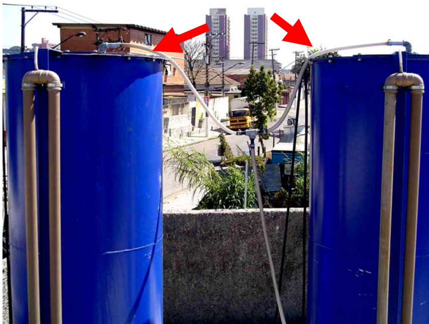
Figura 5.9 - Tubulação flexível para coleta de espuma na saída de ar dos biofiltros
