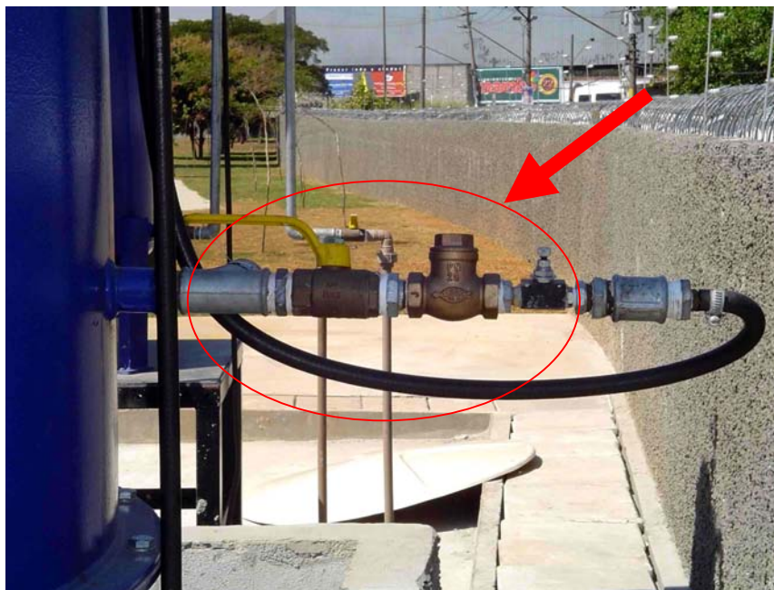
Figura 5.7 - Válvulas de controle de aeração dos biofiltros (da esquerda para a direita: válvula de esfera, válvula de retenção e válvula reguladora de fluxo)
