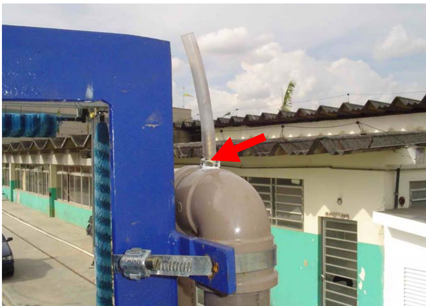
Figura 5.11 - Dispositivo entrada de ventilação na tubulação de saída dos BAS.
