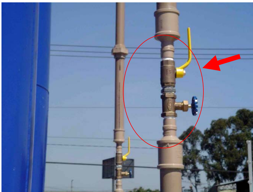
Figura 5.10 - Válvulas de bloqueio (superior) e de ajuste (inferior) da vazão de água dos biofiltros
