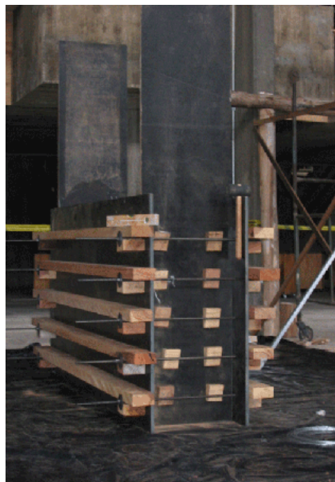
Figura 3.30: Fôrma montada (travamento e cunhas). Obra no SESC-Pompéia (SP), 2003. Foto: André Heise, 2003.
