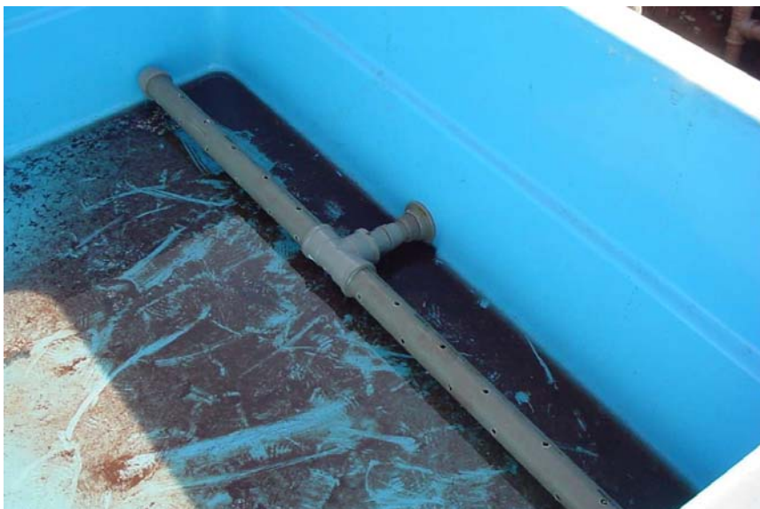
Figura 5.8 – Detalhe do coletor implantado na saída do sistema.
