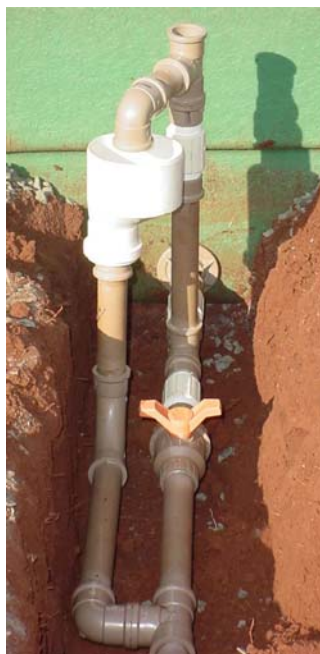
Figura 5.9 – Sistema de saída e controle de nível instalado no sistema.
