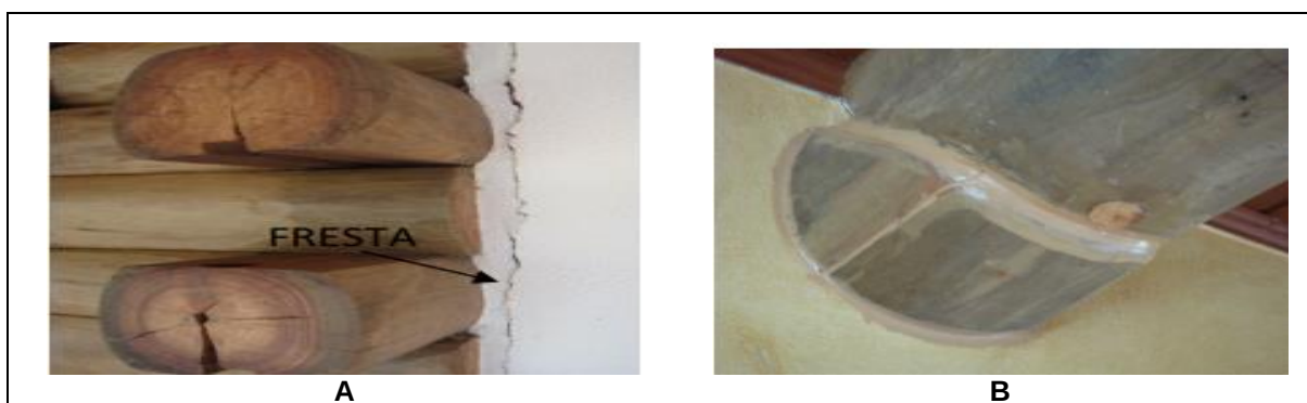
A: Fresta entre a madeira e a alvenaria; B: Peça com a utilização de mastique. Fonte: ALTOÉ, 2009.
