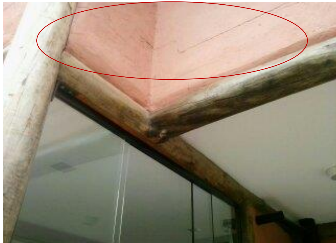
C: após 5 anos de execução, fissura e descolamento da alvenaria de vedação, fissura na laje de piso em 2017
