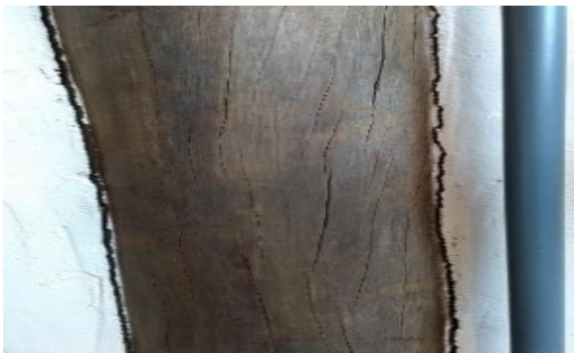
D: vista interna do descolamento de alvenaria de blocos de concreto na interface interna das paredes da residência, em Embu das Artes após 5 anos de executada.
