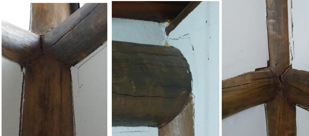
B/C/D: pode-se observar o aparecimento de manifestações patológicas. A manifestação apresentada nessas figuras é o descolamento entre a estrutura de madeira e as placas de fechamento internas (drywall)
