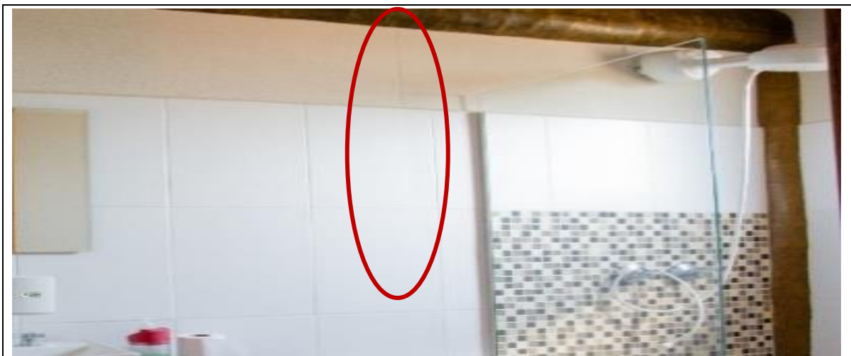
A; B e C: fissuras nos revestimentos das paredes internos do banheiro. D: vista interna do banheiro e placas de drywall revestidas. Fonte: Arquivo pessoal, 2013.
