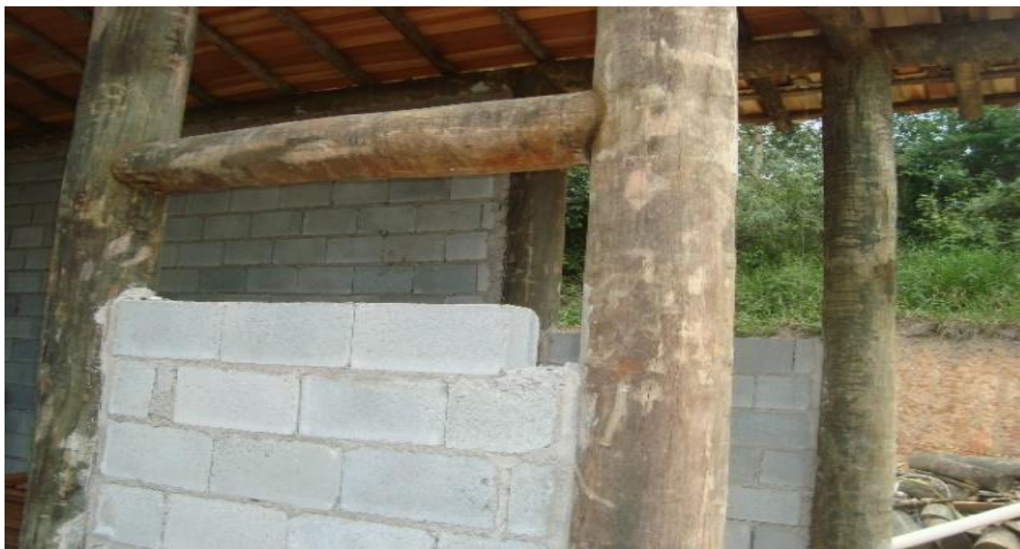
C: blocos de vedação de concreto, não foram instalados pregos na interface da madeira/alvenaria
