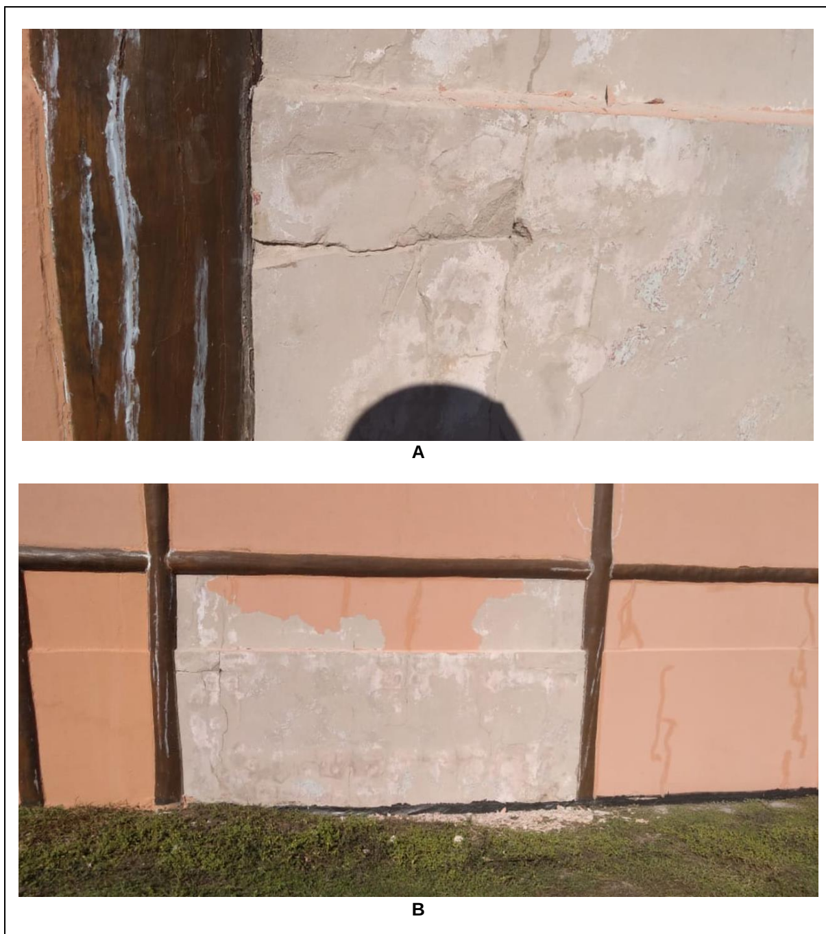
Figura 37 – Registro de manutenção na parede de estudo da residência E.
