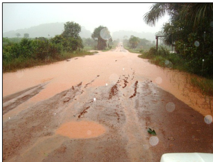
Foto 7. Alagamento da rodovia MT 325 no entroncamento com 1ª vicinal Sul. Alta Floresta-MT.
