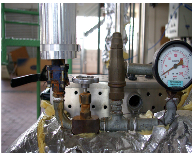
Figura 21 - Válvulas de controle do vapor
