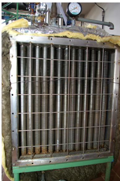
Figura 20 - Conjunto de resistências elétricas e radiador de vapor
