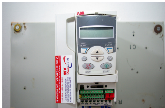
Figura 19 - Inversor de frequência
