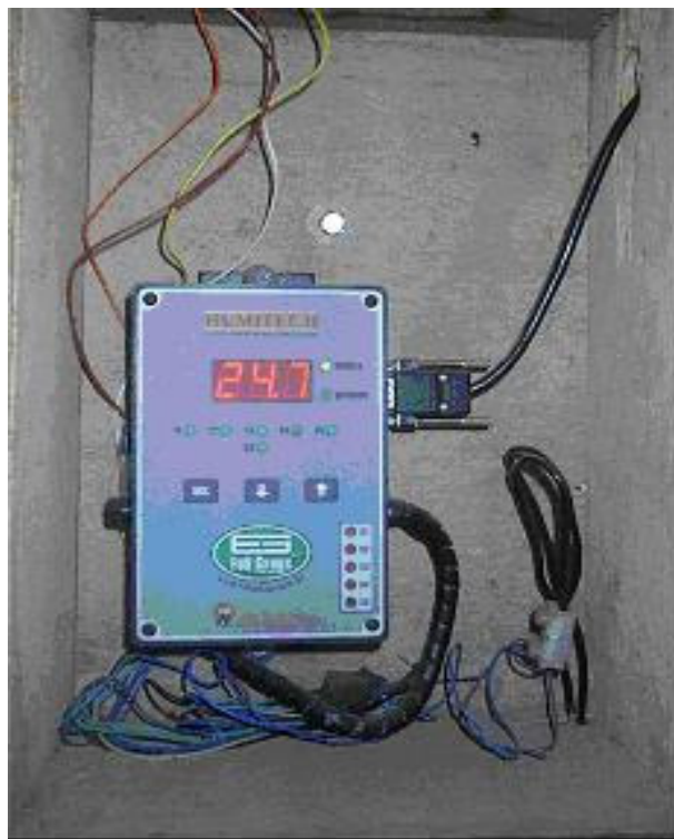
Figura 9. Controlador automático de climatização.
