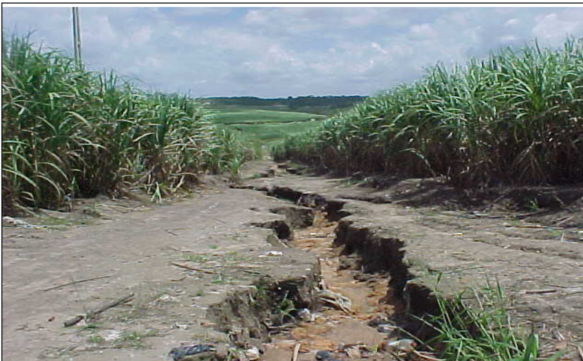
Foto 7 – Estrada rural degradada por erosão hídrica.
