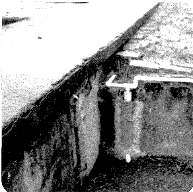
FIGURA 4.6. Vista do purgador.
