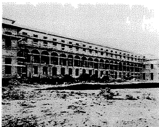
Construção do prédio do Liceu Pasteur na rua Mairinque, Vila Mariana, em São Paulo
