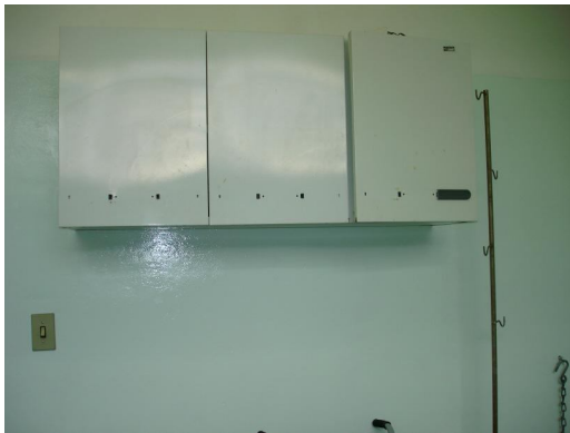
Figura 16 - Armário desativado na Sala de Curativos “F”
