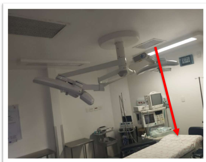
Figura 22. Foto da Sala de Parto com a saída do ar condicionado posicionada diretamente sobre a cama de parto (representação pela seta vermelha). Foto e intervenção: autor.
