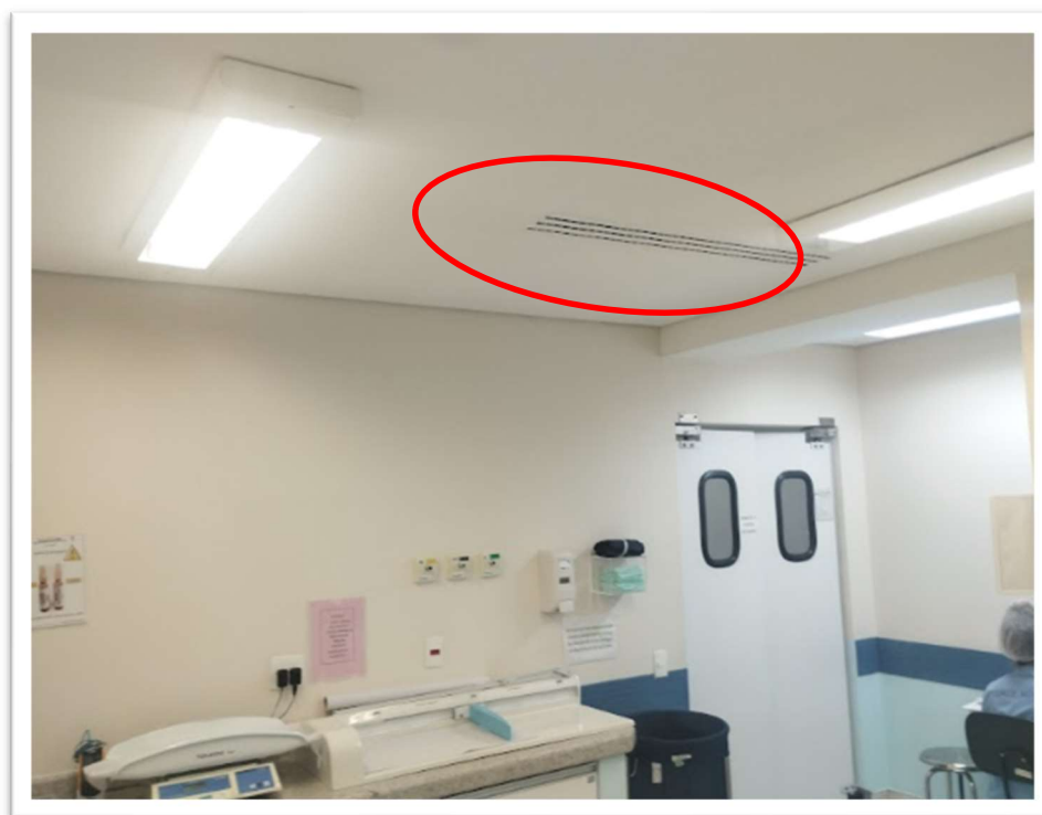
Figura 24. Grelha de saída do ar condicionado na Sala de Assistência ao Recém Nascido.
