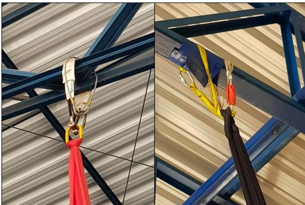
Figura 1 - Exemplos de instalações em treliças metálicas.
