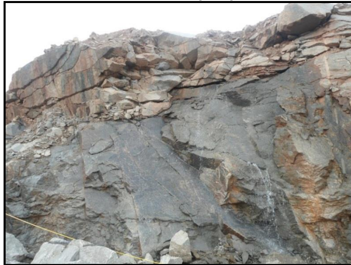
Figura 3.11 – Surgimento de água no talude entre a face da cava e os reservatórios a NE da área de pesquisa
