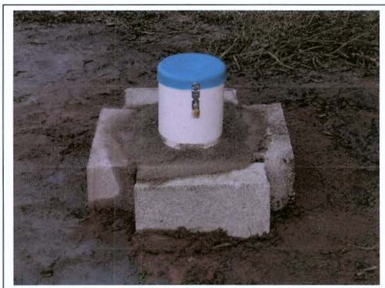
Figura 4.1 – Poço de monitoramento instalado no Sítio de Pesquisa.
