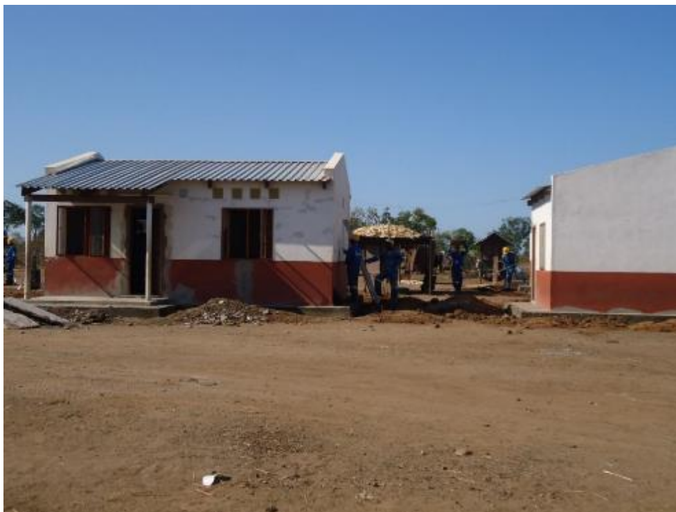
Imagem 13: Conserto das casas rachadas no reassentamento do Cateme, 2013. Foto cedida por Inácio Carvalho.
