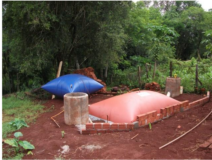
Figura 7.3: Exemplo de um balão de armazenamento (balão azul, disposto ao lado do biodigestor), acoplado a um biodigestor tipo Canadense.
