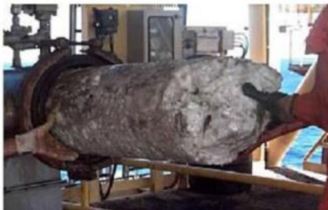
Figura 3.7 – Bloqueio de tubulação de gás natural pela formação de hidratos
