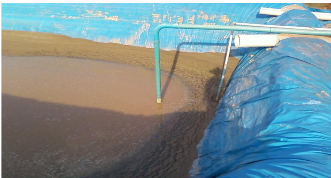
Figura 16: Tanque de armazenamento de efluente
