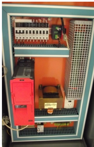
Figura 3.8 - Quadro elétrico com inversor de frequência da planta-piloto do L-CFD.
