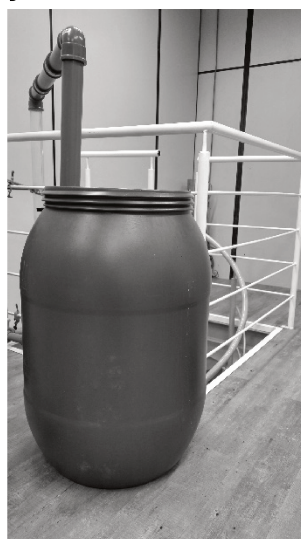
Figura 56 — Tanque de separação de fases
