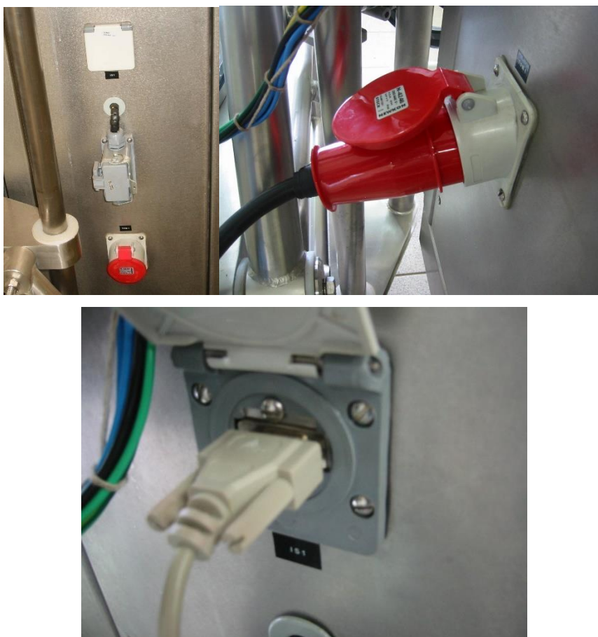
Figura 4.11 – Tomadas de alimentação do painel elétrico do piloto de 50 L. Fonte: Jefferson Luiz Grangeiro da Silva (arquivo pessoal).
