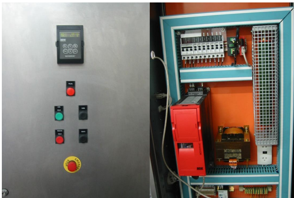
Figura 4.10 – Parte frontal e interna do painel elétrico do piloto de 50 L. Fonte: Jefferson Luiz Grangeiro da Silva (arquivo pessoal).
