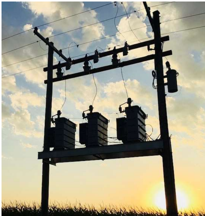
Figura 3.7 – Banco trifásico de SVGs. Extraído de [13].
