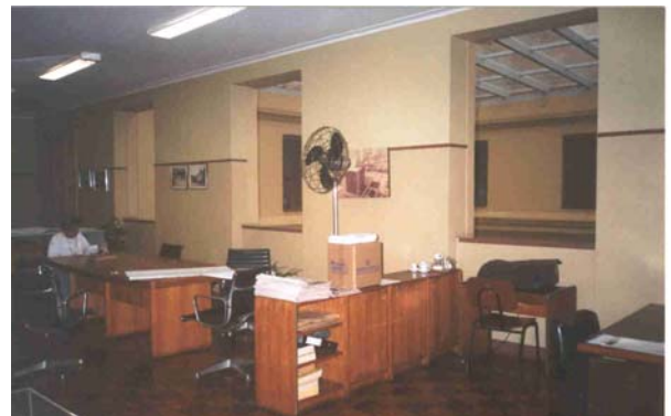
Foto 4: vãos sem esquadrias
