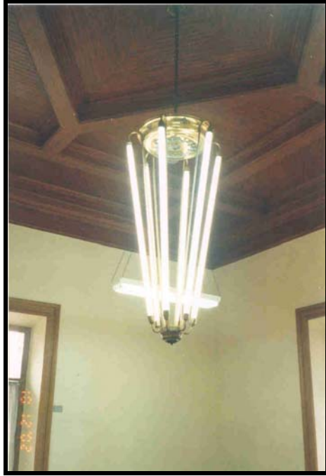
Figura 23- Tipo de luminária utilizado nos edifícios 148 e 184;
