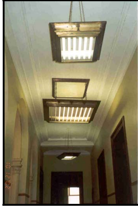
Figura 24 - Sistema de iluminação da circulação, edifício 148 – 2 o pavimento;
