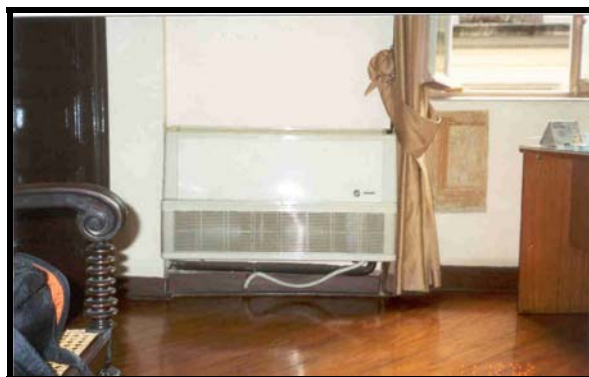
Figura 17 – localização dos aparelhos de ar-condicionado dos edifícios
