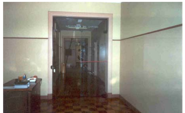
Foto 5: Acesso ao Setor de Arquitetura e Engenharia - porta blidex substituindo porta em madeira;
